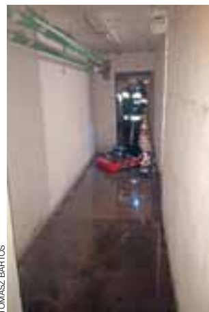
Poziom wody ze ściekami, która zalała piwnice bloków, wynosił od 6 do 10 cm.
