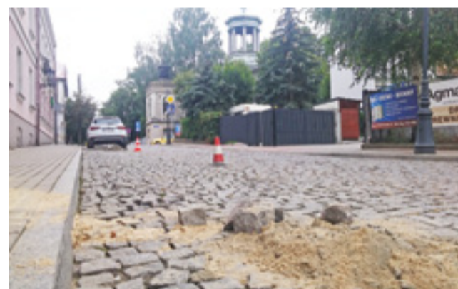
Pracownicy działu drogowego Zakładu Usług Komunalnych zajmowali się 17 sierpnia brukiem na fragmencie ul. Browarnej. Po stronie wschodniej w wielu miejscach spoiwo, które stabilizuje betonową kostkę, zostało wypłukane przez wody opadowe, spływające ulicą w dół w kierunku ul. Starorzecze. Spowodowało to wypadanie granitowych kostek. Naprawa dotyczyła kilku miejsc, które były w najgorszym stanie. tb
