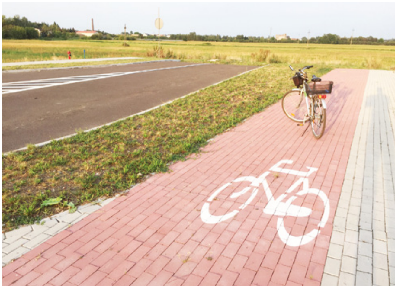
Przedłużenie ul. Piłsudskiego, czyli ul. Dmowskiego, ma być budowane, jak tylko rozstrzygnięty zostanie przetarg. Droga rowerowa, jak widać, jest planowana. Burmistrz już zapowiedział, że będzie asfaltowa.
