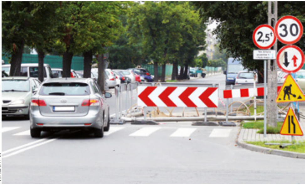
Zabezpieczony wykop na ulicy Sikorskiego zajmuje szerokość jednego pasa ruchu, warto o tym pamiętać skracając z ul. Powstańców.
