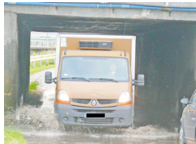
Przejazd pod wiaduktem kolejowym na ul. Arkadyjskiej niemal po każdej większej ulewie zalany jest wodą.
