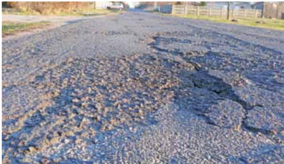
Spekany i wykruszony asfalt na drodze przez Mysłaków Bąkowiec ma być przykryty nowym w czasie budowy ścieżki pieszo-rowerowej Łowicz – Nieborów.
