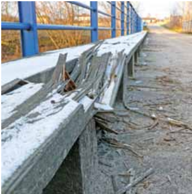
Drewniany podest znajdujący się przy barierkach jest w dwóch miejscach podobnie zniszczony – zupełnie jakby ktoś specjalnie w tych miejscach po nim skakał.
