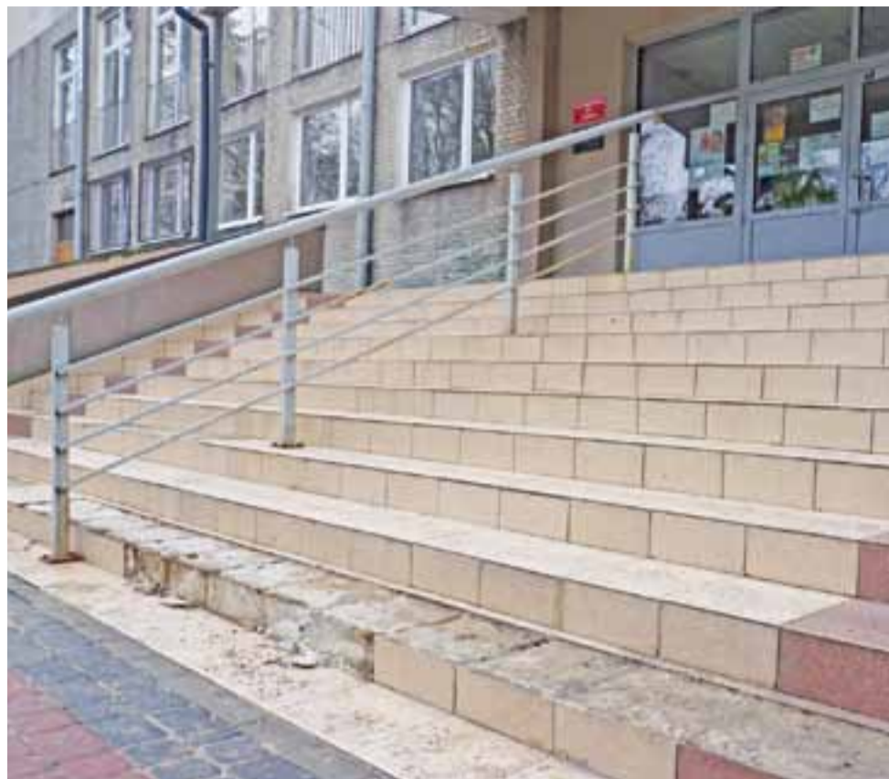
Po trzech tygodniach mrozów i śniegu część płytek ze schodów Żychlińskiego Domu Kultury znów odpadła. Podobnie było w ubiegłym roku.
