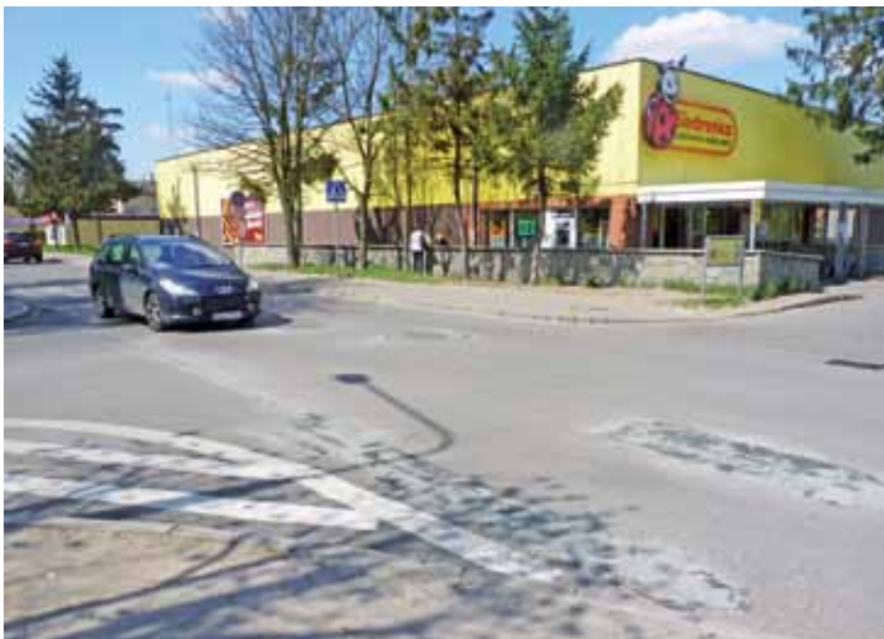
Oddane do użytku 5 miesięcy temu skrzyżowanie ulic Marchlewskiego i Hanki Sawickiej, koło Biedronki – pęka. Na razie jest naprawiane w ramach gwarancji.
