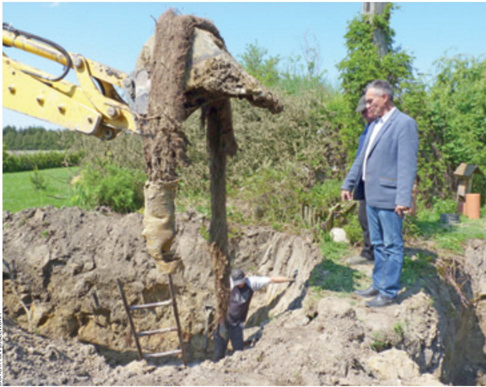
Na tyżce od koparki wyciągnięto fragment uszkodzonej rury melioracyjnej z 5-metrowymi korzeniami wierzby.
