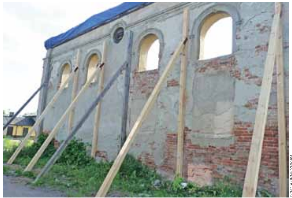
Od strony wschodniej uzupełniono już brakujące tregry, co widać, gdyż odróżniają się od starych kolorem.
