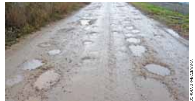
Po deszczach w ulicy Dobrzeleńskiej wysypanej tłuczniem z rudą gliną powybijały się liczne dziury, których nie sposób ominąć.
