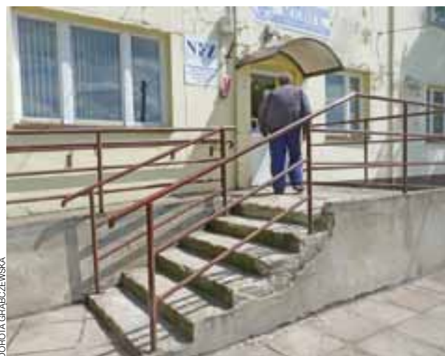
Schody do przychodni stwarzają teraz zagrożenie.
