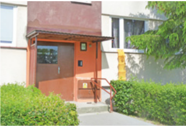
Daszki nad wejściami do klatek w bloku Łąkowa 13a stały się utrapieniem dla mieszkańców. Gdy pada deszcz, z daszków leci kurtyna wody.
