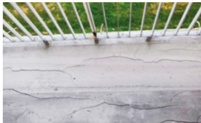
Balkon pana Staszewskiego był popękany straszliwie. Pęknięcia miały kilka milimetrów.
