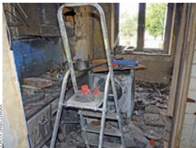
Ogień w komunalnym lokalu przy Narutowicza 4 strawił całe pomieszczenie.
