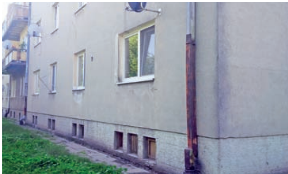
Blok przy ul. H. Sawickiej będzie miał wymienione rynny oraz ma być poprawiony stan dachu.
