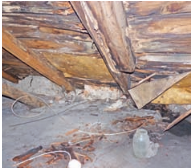
Deski dachowe na budynku Narutowicza 30, od strony podwórka są w wielu miejscach całkowicie spróchniałe, a przez dach w kilku miejscach widać niebo.
