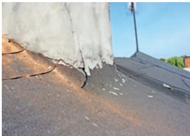
Tak wygląda dach pokryty mnóstwem kawałków papy, bez lepiku. Przez dziury przy kominie woda też leje się ciurkiem do środka.
