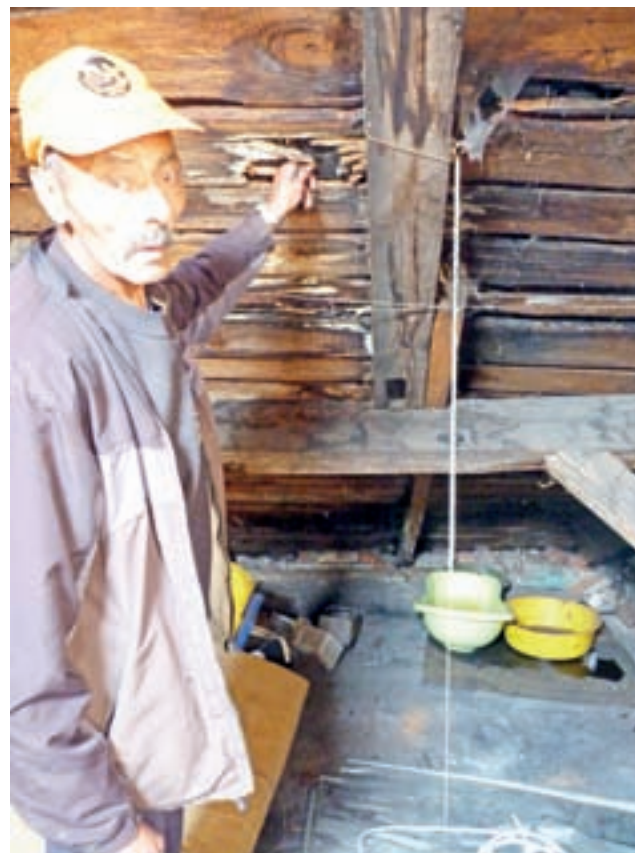
Ryszard Więcek pokazuje, w jakim stanie jest dach w kamienicy będącej w zarządzie ZSB. W miejscach przecieków podstawione są miski i wanienki, by woda całkowicie nie zalała mieszkań.
