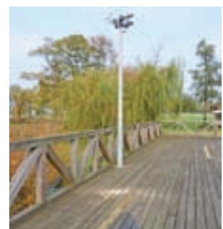
Na molo w Pniewie widać tylko dwie nowe deski. Widać też kamery monitoringu.
